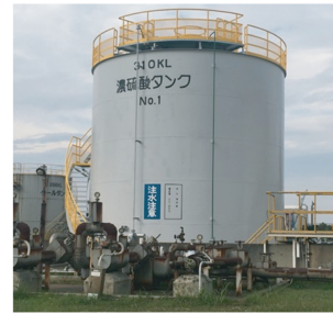
図9 開発鋼が適用されたタンクの外観
